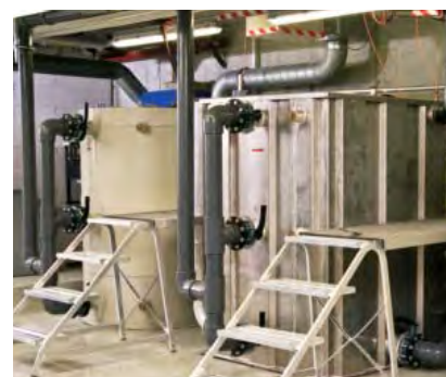
Измерение уровня в станциях водоочистки
